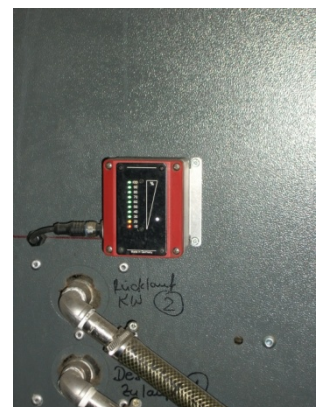
Rückkühler einer Destille
